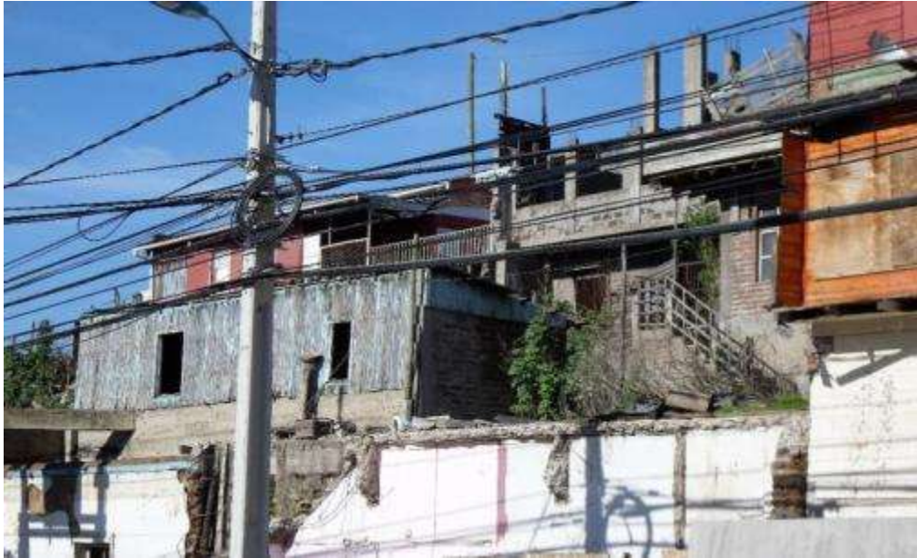
Estado actual de edificaciones emplazadas en la acera sur de calle Gregorio Mira, en El borde sur del casco céntrico
